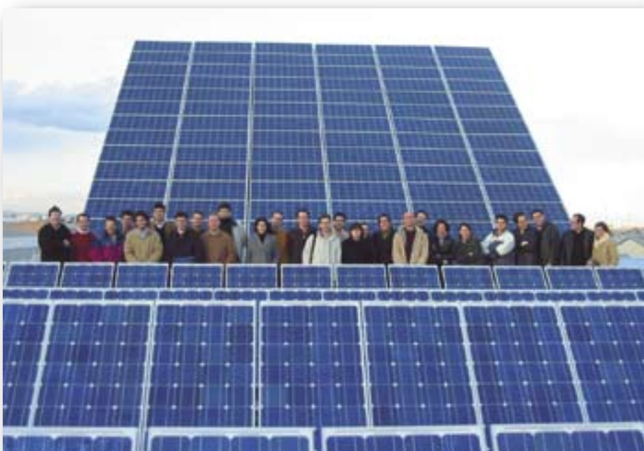
Alumnos del Curso de Consultor en Energías Renovables en las instalaciones de Atersa.
